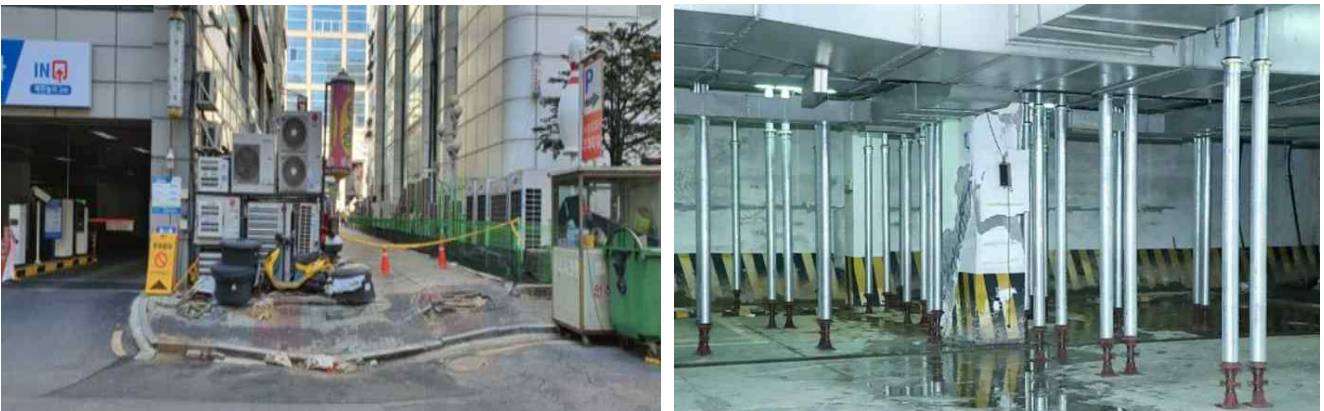
<그림1> 마두동 지반 침하 및 건축물 붕괴 위험 사고 발생 현장
